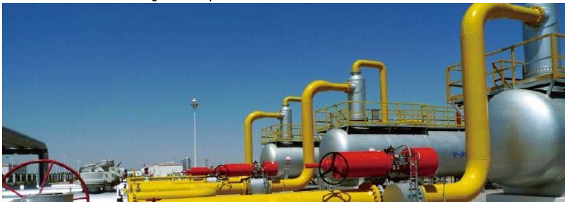
Un tratto della sezione Uzbeka del gasdotto Sampede-Lunnan
