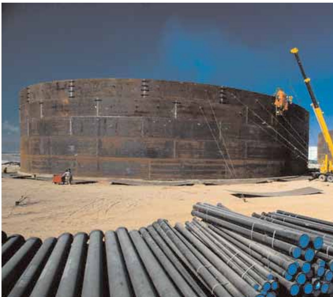
Serbatoi di stoccaggio carburante nei pressi di Aqaba
