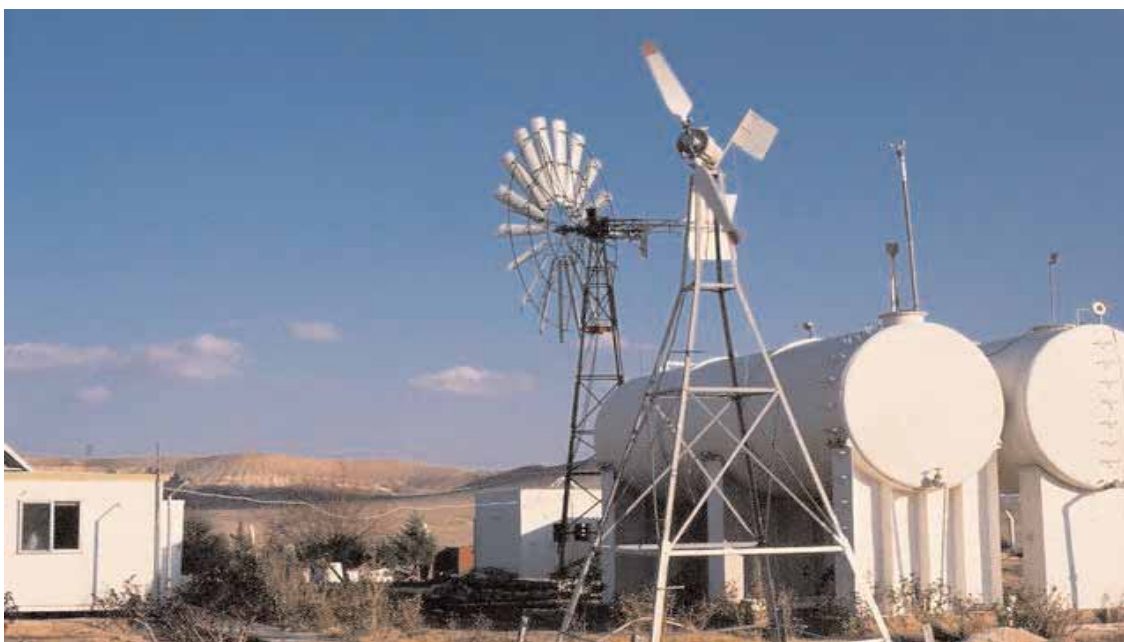
Un impianto di pompaggio acqua alimentato dall'energia eolica nel deserto della Giordania
